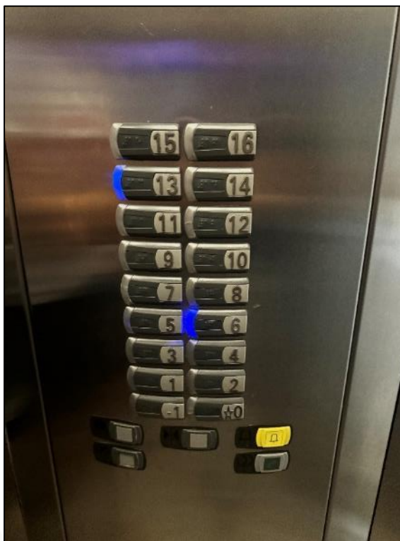
Fotos 33 – Painel de comando do elevador.
