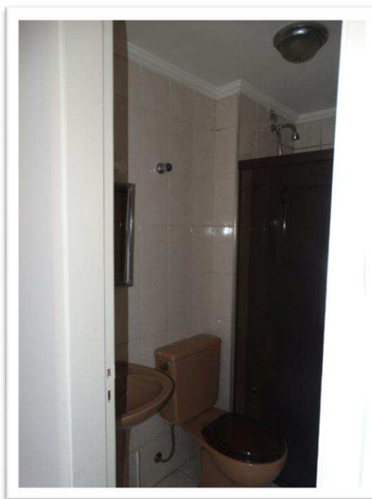
Foto nº 53 - Vista parcial interna do apartamento de nº 92, do Bloco “A”, vistoriado por similaridade com o imóvel avaliando – Banheiro Social.
