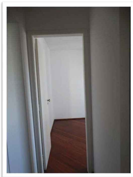
Foto nº 50 - Vista parcial interna do apartamento de nº 92, do Bloco “A”, vistoriado pela similaridade com o imóvel avaliando – Porta do Dormitório 3.
