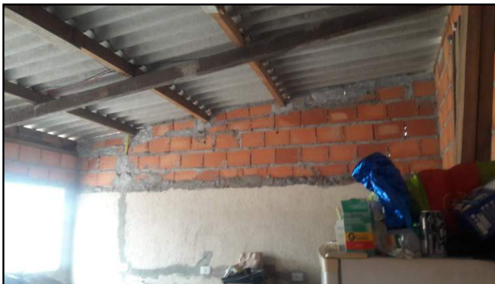
Foto 11 – Cozinha /Sala Superior Frente – piso cimentado, inacabado.
