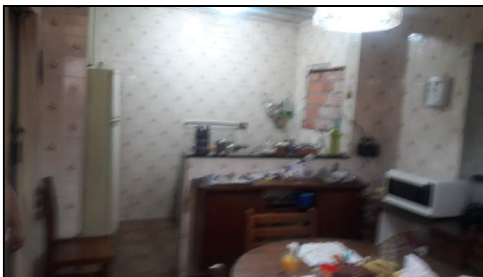
Foto 7 – Copa Cozinha térreo , piso cerâmico, parede azulejo, teto sinais de umidade
