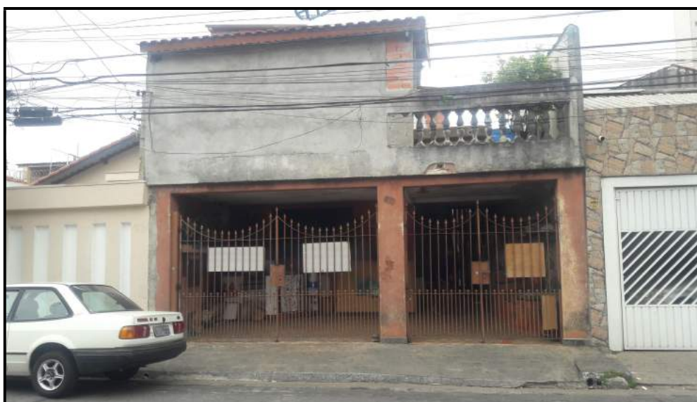
Foto 1 – Fachada – portão em ferro, necessitando de pintura, piso superior parede no reboque sem acabamento
